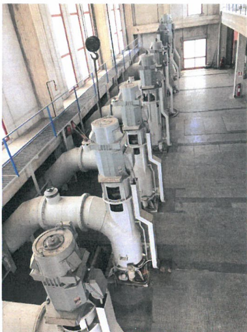
Impianto idrovoro di Foce Sele (pompa)
