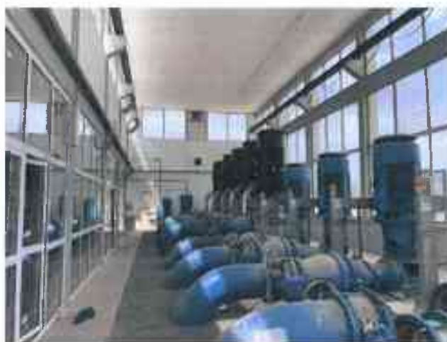
Impianto di sollevamento della località Scigliati
