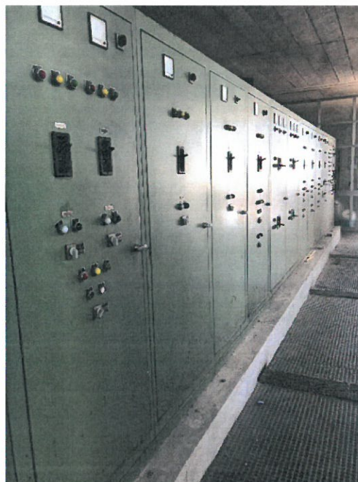
Impianto idrovoro di Foce Sele (quadri elettrici)
